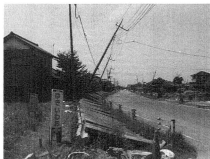
写真4 浮き上がった側溝の蓋と傾いた電柱(日の出5丁目: 2011年5月8日撮影)
