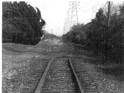
写真9 歪んだ鹿島臨海線の線路（東深芝：2011年4月10日撮影）
