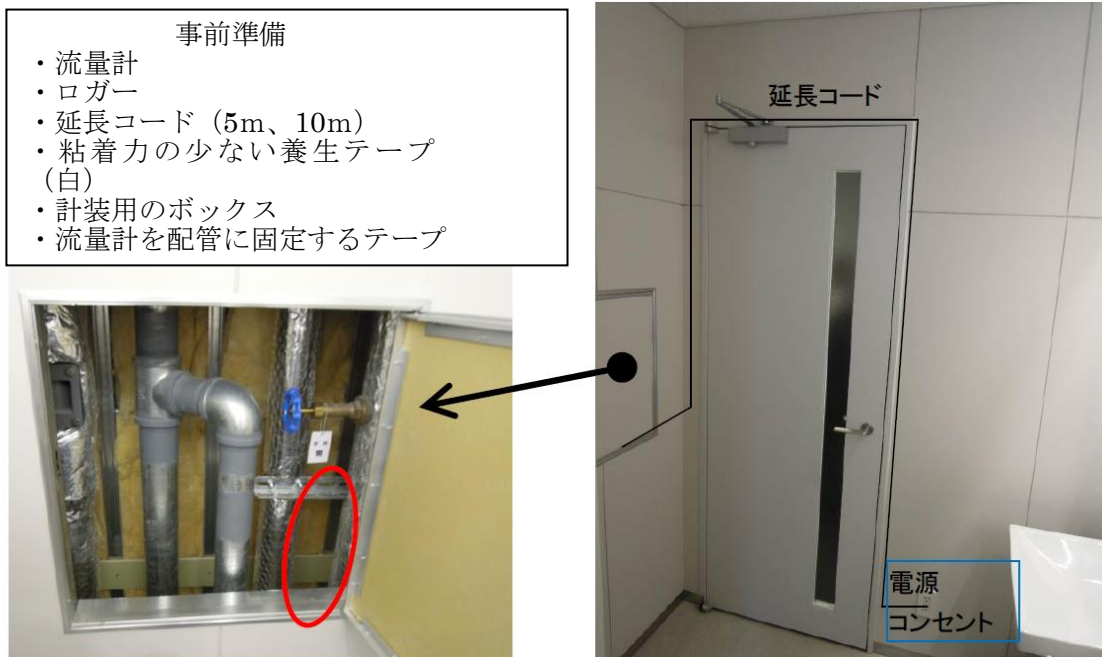
写真 3.1.1-11 流量計現場設置状況
