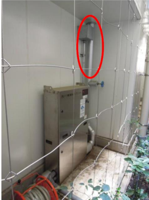
写真 3. 1. 1-5 流量計検出器の設置箇所（全階）
