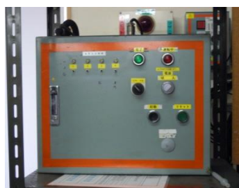
大便器同時洗浄制御装置
