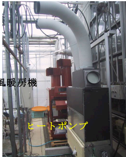
写真 1-1 試験に用いたヒートポンプと重油式温風暖房機
